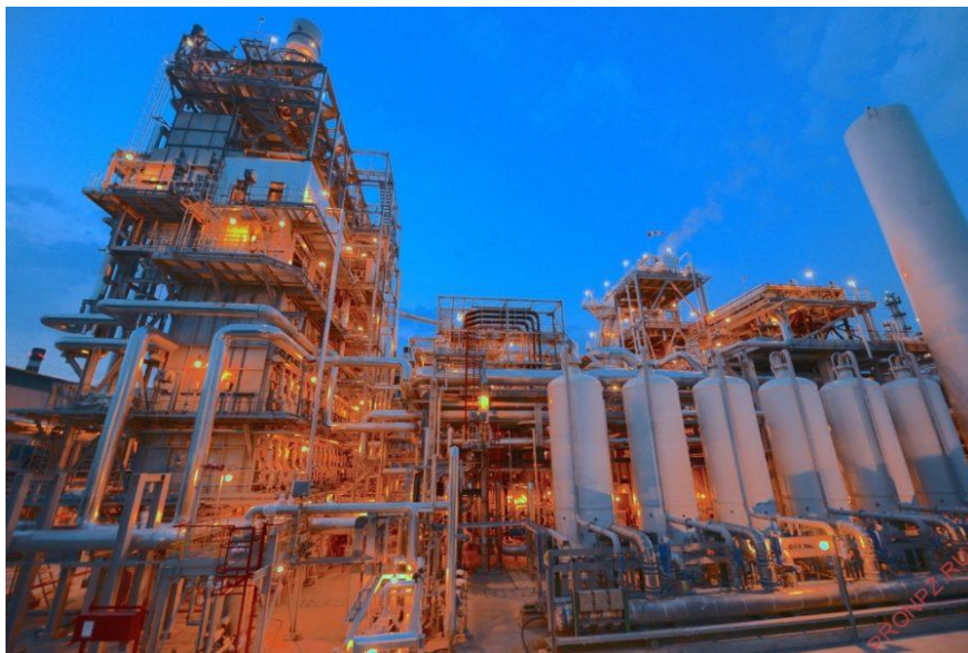
Фото 1. Установка производства водорода (УПВ-22)
