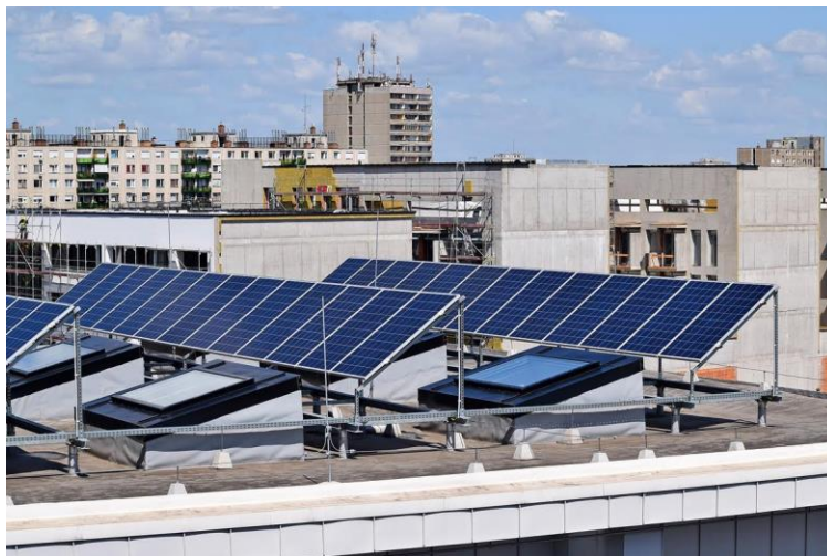
Рисунок 5. Солнечные панели на крыше здания
