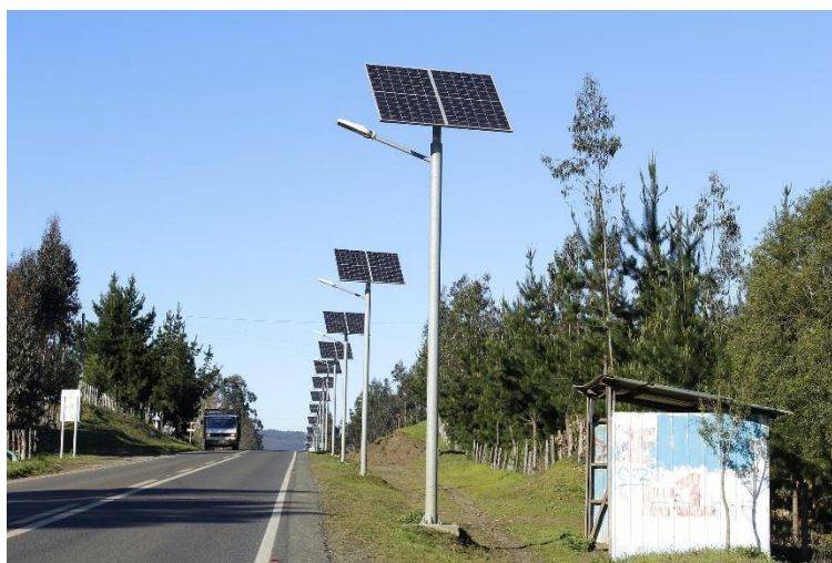
Рисунок 3. Организация наружного освещения с использованием солнечных панелей
