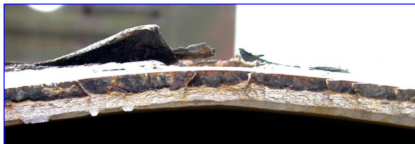
Рисунок 5.12. Разрушение плети по катушке 319-2: Зональное строение излома: участок коррозионного роста трещины (1), участок развития (подрастания глубины) дефекта при испытании (2) и зона долома (3)
