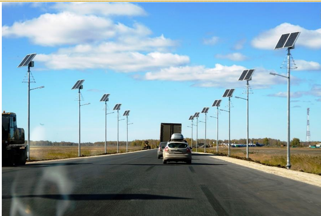
Рисунок 1. Осветительные установки SOL-40 у села Малиновка Тюкалинского района.
