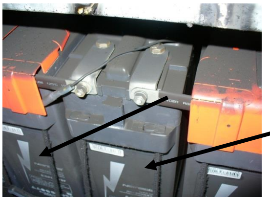
Рисунок 7. Вид на контактные пластины последовательного соединения неповрежденных аккумуляторных батарей, расположенных на первой полке электрошкафа (стойке) электропитания. Стрелками указано на контактные зажимы, гайки на которых полностью затянуты
