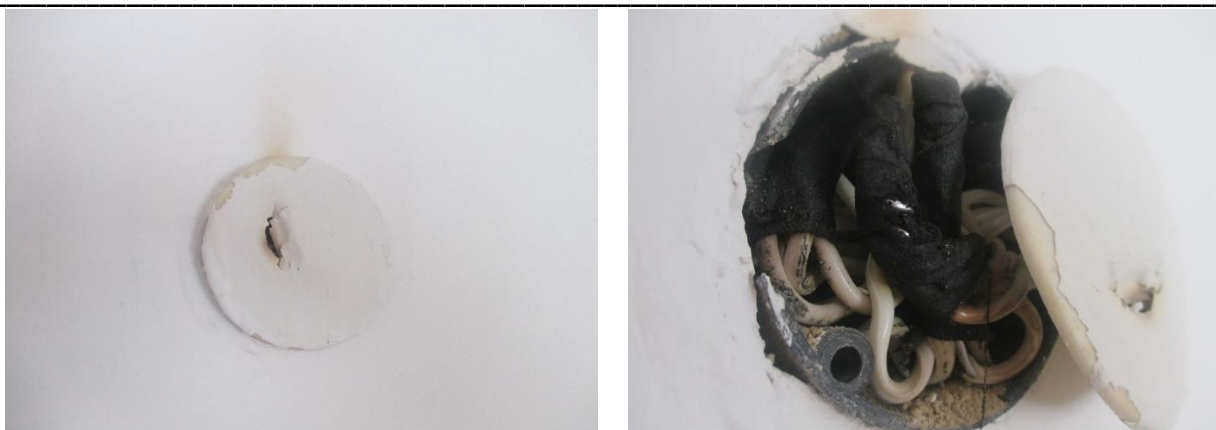
Рисунок 2. Вид на ответвительную коробку встраиваемого типа для скрытой электропроводки
