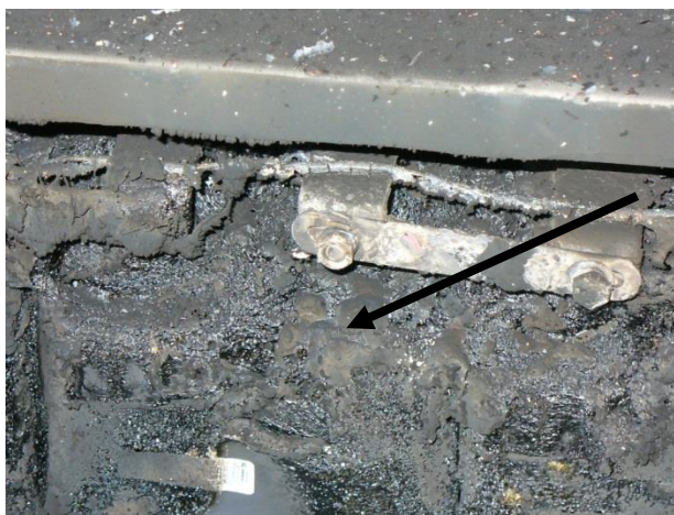
Рисунок 8. Вид на локально поврежденную контактную пластину аккумуляторов, расположенных на второй полке электрошкафа электропитания. Изоляция на контактной пластине полностью выгорела
