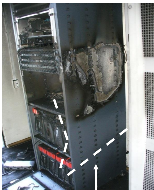
Рисунок 4. Вид на западную (правую) стенку электрошкафа (стойку) электропитания. Стрелкой указано на участок выгоревшей краски стенки, который начинается от уровня верхней части аккумуляторов второго отсека электрошкафа. Следы обгоревшей краски на стенке в виде проекции конуса выделены белыми штриховыми линиями
