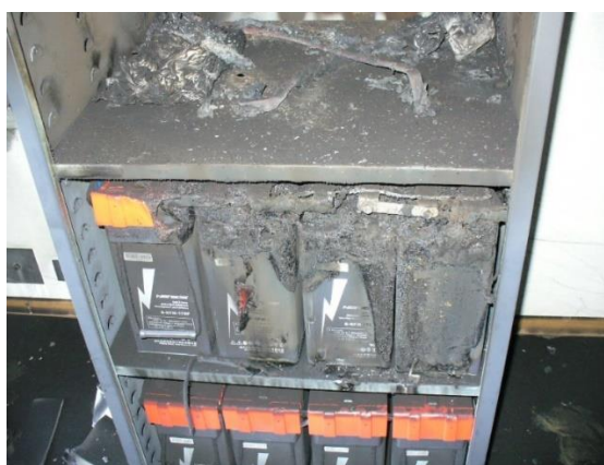
Рисунок 5. Вид на вторую от пола полку электрошкафа электропитания
