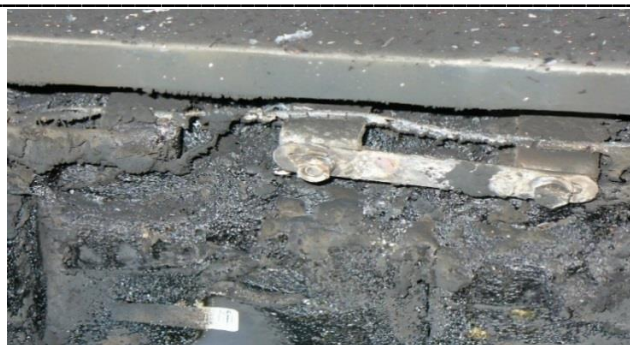
Рисунок 6. Вид на локально поврежденную контактную пластину аккумуляторов. Изоляция на контактной пластине полностью выгорела
