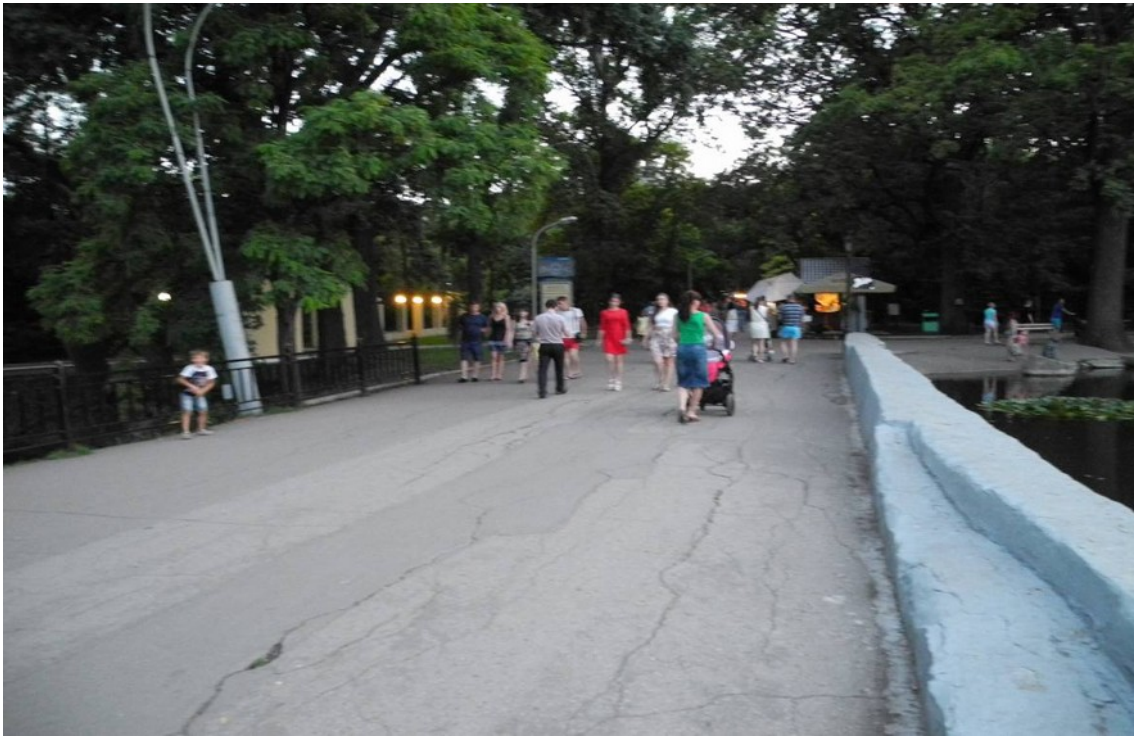
Рисунок 1. Фрагмент дорожно-тропиночного полотна части центральной дорожки ПКиО им. М. Горького (Горпарк) со стороны входа с ул. Рахова (фото автора)
